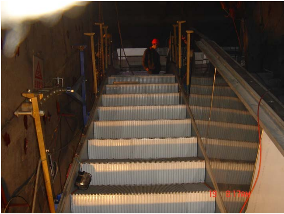
图50 隧道式自动扶梯
